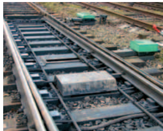
Рис. 11. Стрелочный привод с контрольным устройством
