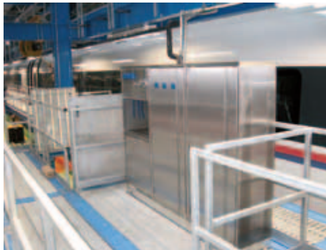
Рис. 8. Подвесная сервисная площадка на уровне 1,36 м над УГР
