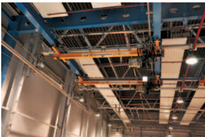
Рис. 10. Мостовые краны для работы с крышевым оборудованием
