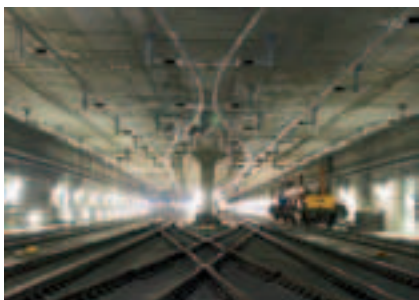
Рис. 3. Контактная подвеска жесткого типа в тоннеле прямоугольной формы (фото: Furrer+Frei)
