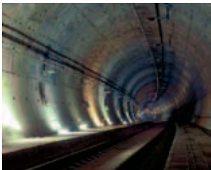
Рис. 4. Контактная подвеска жесткого типа в тоннеле трубчатой формы (фото: Furrer+Frei)
