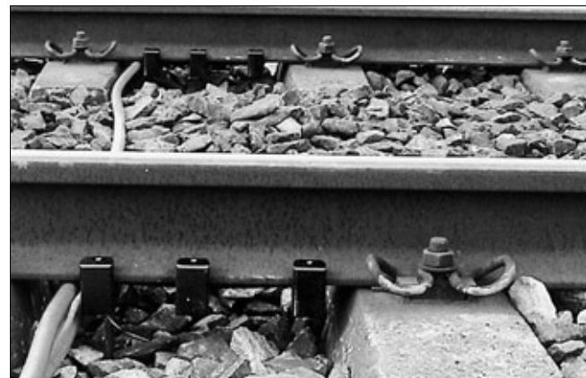
Рис. 2. Установка датчиков на рельсах
