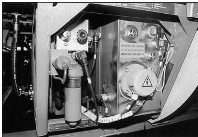
Рис. 8. Датчики и регуляторы подачи масла в гидравлический привод системы наклона кузовов вагонов
