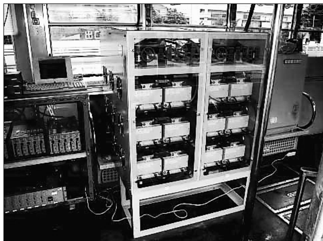
Рис. 1. Бортовая литий-ионная аккумуляторная батарея
