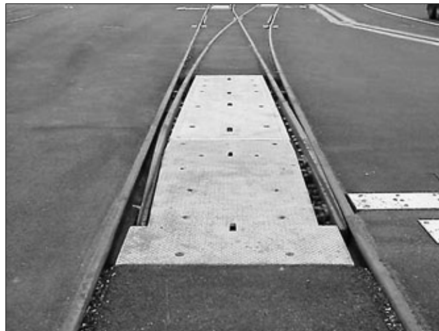
Рис. 4. Металлическое покрытие зоны стрелочного переезда компании Omega Industries
