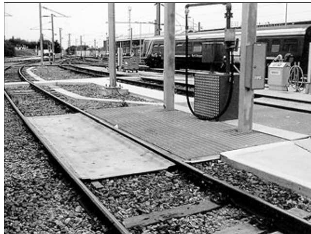
Рис. 7. Типовой пункт заправки подвижного состава топливом, оснащенный устройствами Track Collector
