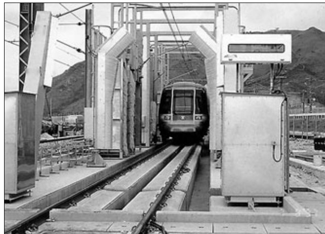
Рис. 3. Современная моечная установка пригородной железной дороги в Гонконге (Китай)
