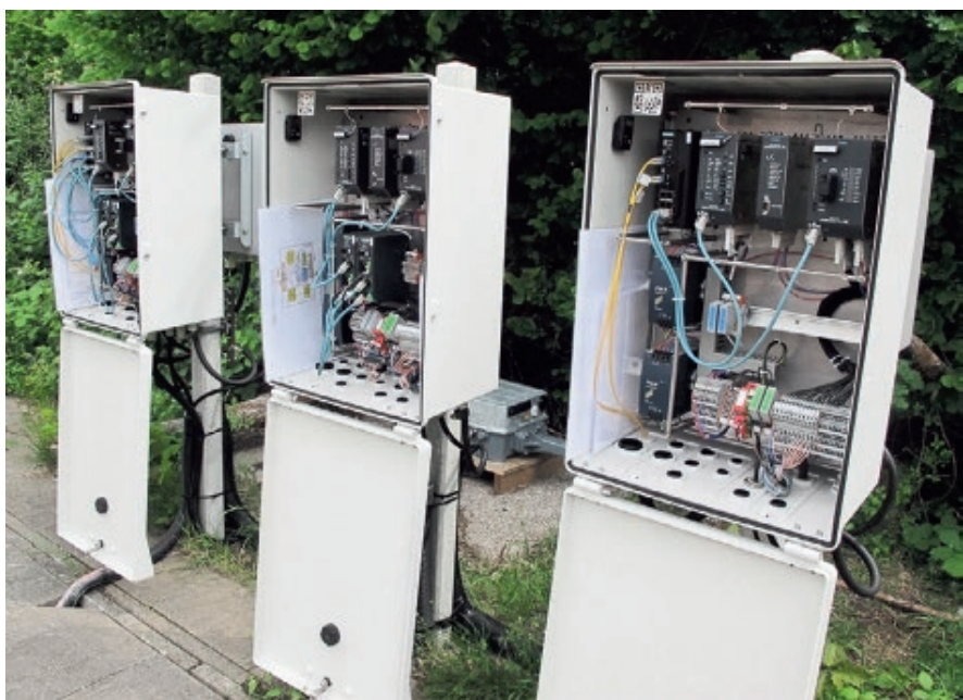
Рис. 7. Путевые шкафы с объектными контроллерами опытной цифровой МПЦ в Брауншвейге
