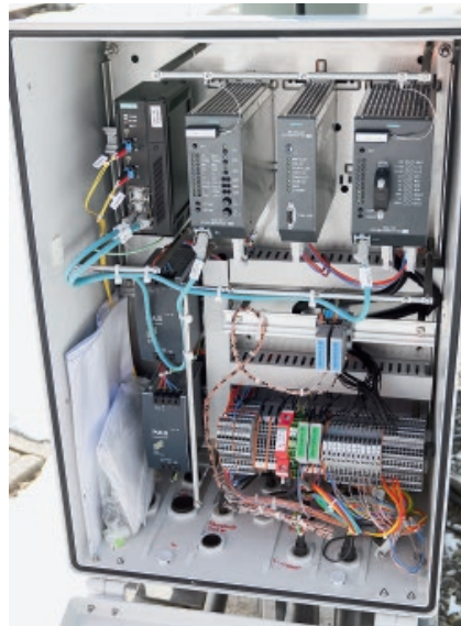
Рис. 4. Путевой шкаф с комплектом телекоммуникационных модулей, объектных контроллеров и устройств электропитания (фото: DB)
