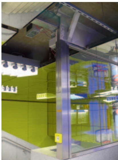
Рис. 2. Мобильное дымоизолирующее ограждение у входа на лестницу
