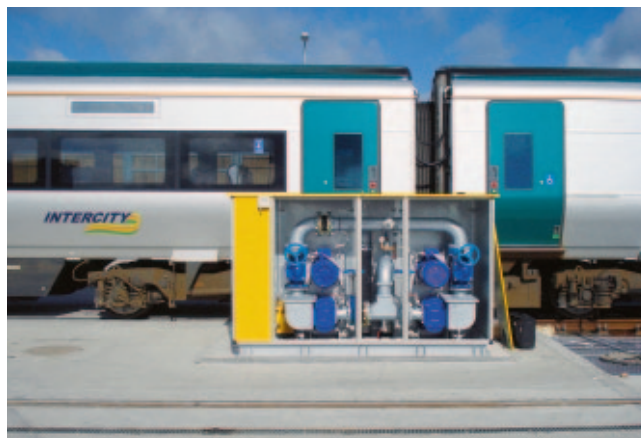
Рис. 6. Насосная станция системы очистки вагонных биотуалетов (фото: Vogelsang)
