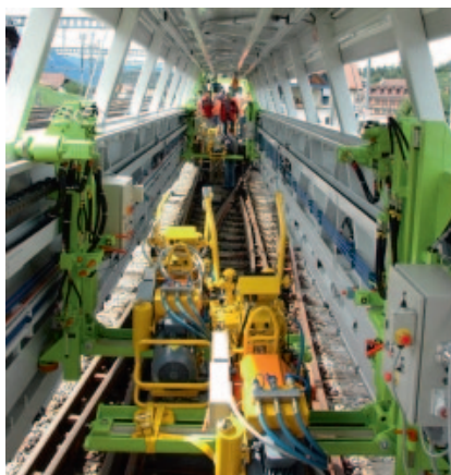
В рабочем вагоне станции МІЕ
