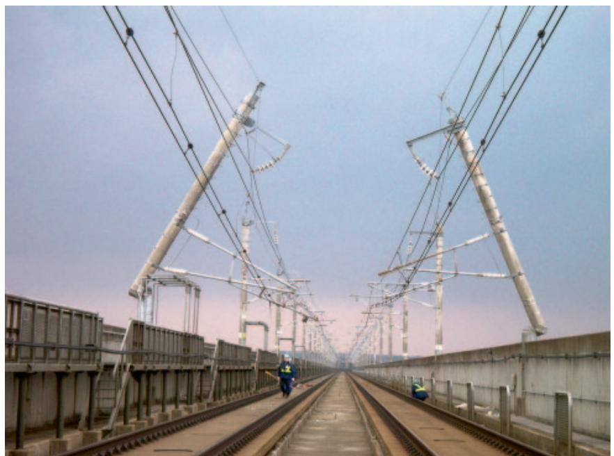
Рис. 1. Поврежденные опоры контактной сети на одной из высокоскоростных линий JR East
