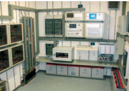
Рис. 2. Аппаратное помещение поста МПЦ на станции Корбах
