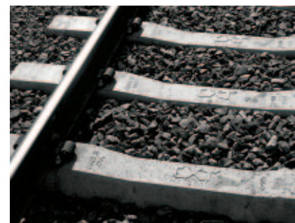
Рис. 1. Путь на железобетонных шпалах компании СХТ
