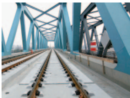
Рис. 4. Уложенный путь на новом мосту через Рейн (справа виден еще не демонтированный старый мост)
