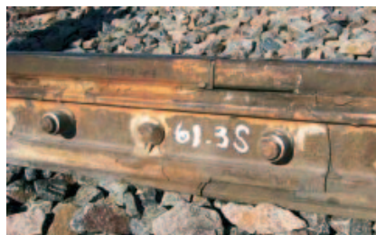
Рис. 5. Излом рельсовой накладки с наружной стороны изолирующего стыка
