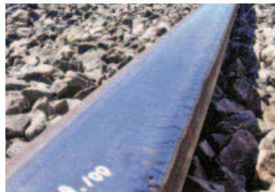
Рис. 9. Дефекты контактно-усталостного происхождения в виде отслаивания металла
