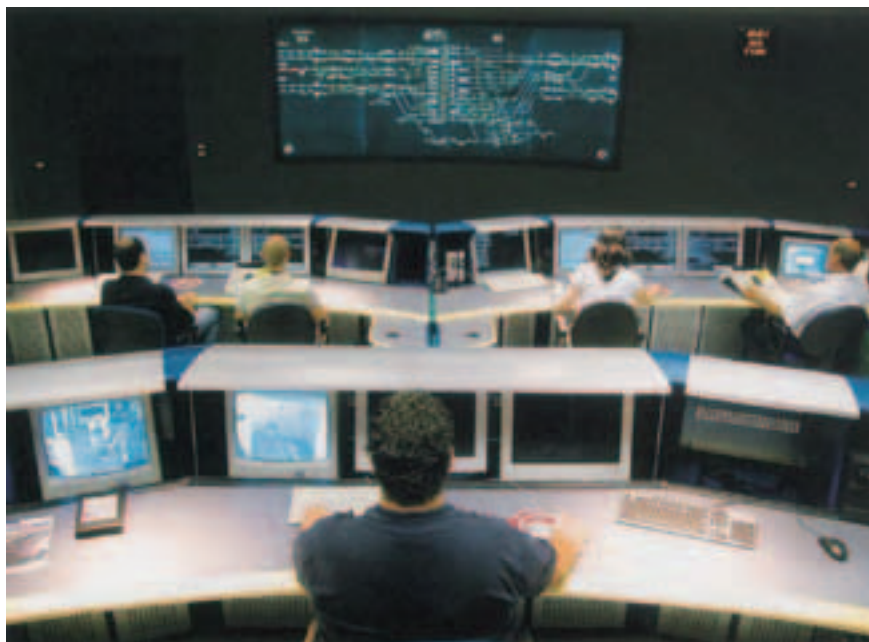
Рис. 4. Центр управления движением поездов высокоскоростной линии Рим — Неаполь, к которому подключены стационарные центры блокировки на базе радиосвязи RBC
