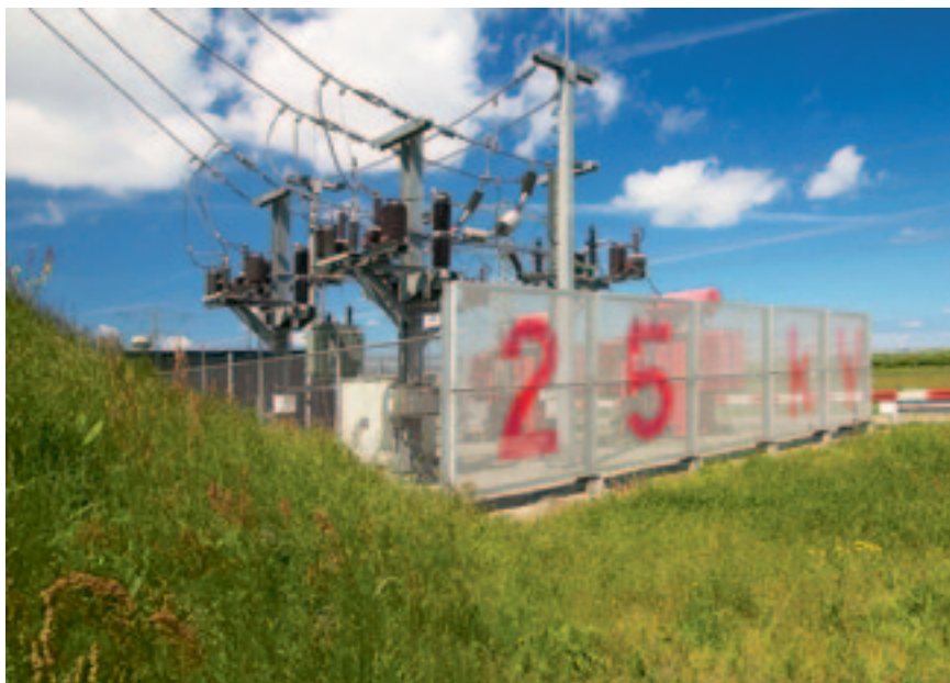
Рис. 2. Устройства системы тягового электроснабжения на линии Betuwe
