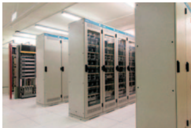
Рис. 4. Шкафы с компьютерным оборудованием на посту МПЦ
