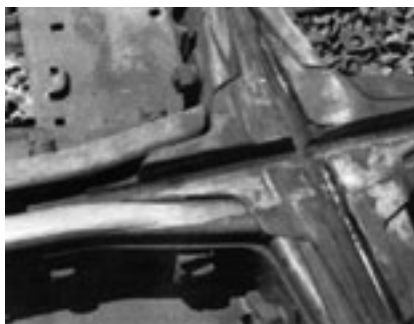
Рис. 3. Крестовина глухого пересечения с наклонной поверхностью катания
