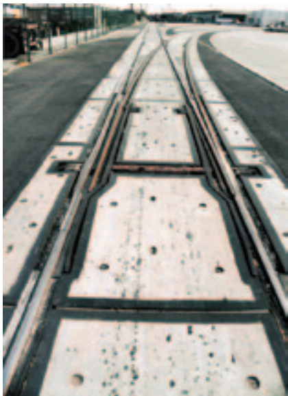
Рис. 1. Покрытие корпорации Century Group в зоне стрелочного перевода
