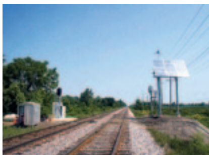
Рис. 3. Солнечная батарея корпорации Kyocera Solar для питания устройств железнодорожной сигнализации
