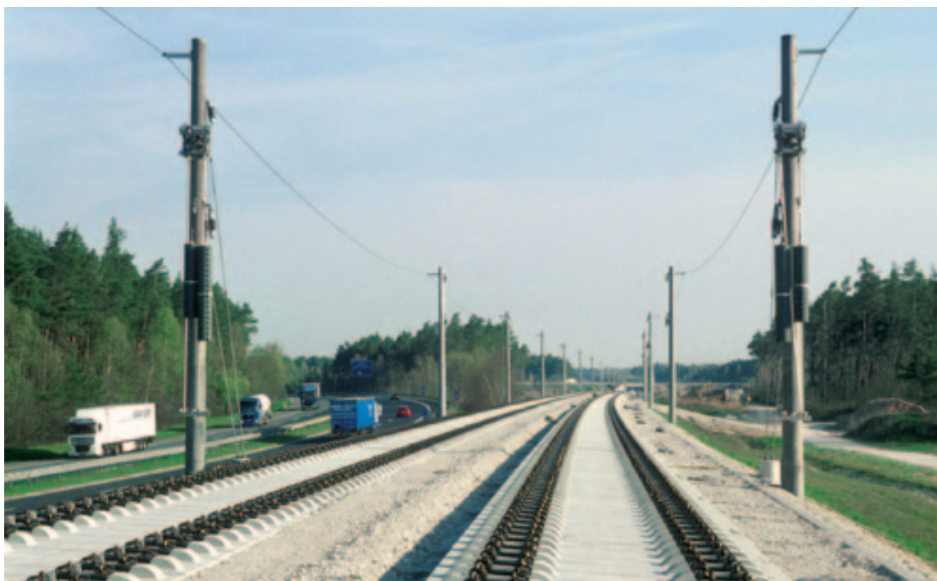
Рис. 1. Участок безбалластного пути типа Vögl на линии Нюрнберг — Ингольштадт (фото: DBAG, Вебер)
