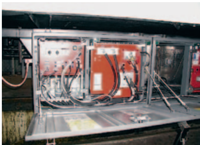
Рис. 7. Многосистемный блок электроснабжения вагона серии Arpz
