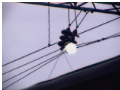
Рис. 12. УФ-изображение двух гирлянд (опора № 117)
