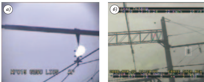
Рис. 7. Фрагмент УФ-диагностирования гирлянды из трех изоляторов ПФ-70 на станции Вятские Поляны (опора № 50): а—УФ-изображение; б—видеоизображение
