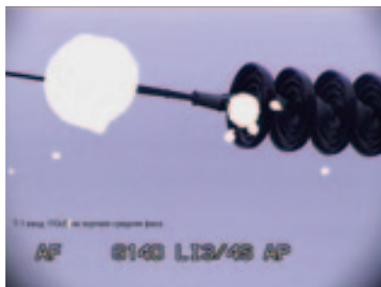
Рис. 11. Ввод 110 кВ на портале Т-1 тяговой подстанции Агрыз
