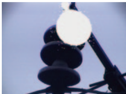
Рис. 13. УФ-изображение изолятора ПФ-70 со стороны КТП
