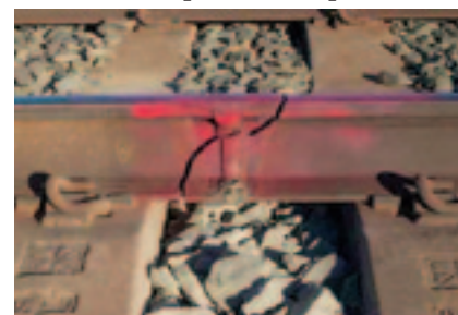
Рис. 2. Излом рельса в зоне сварного стыка
